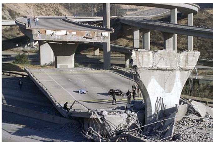
1994年ノースリッジ地震 高速道路橋の落下
