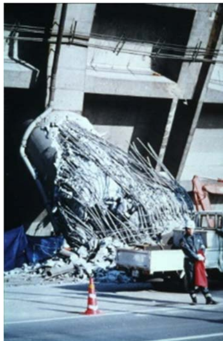
阪神高速道路橋の被害
